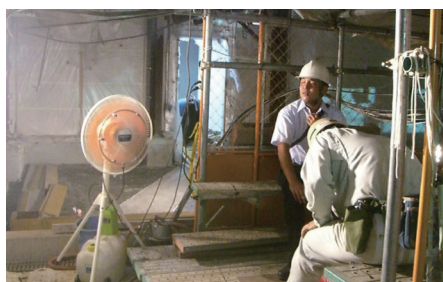
屋内(休憩所)(熱暑対策)
