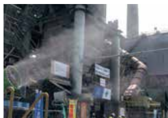
工場敷地 (熱暑・粉塵対策)
